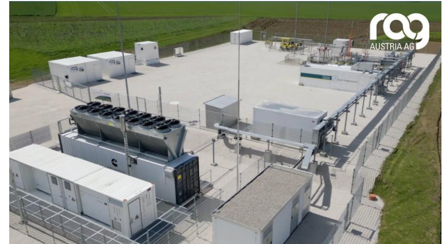
Quelle: Energiespeicheranlage Rubensdorf, RAG Austria AG
