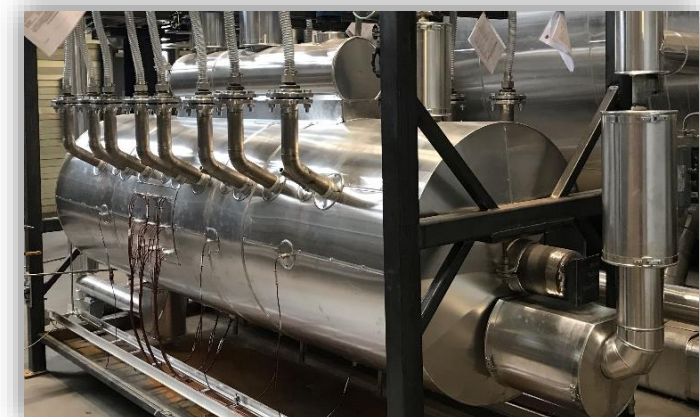
Speicher mit Isolation
