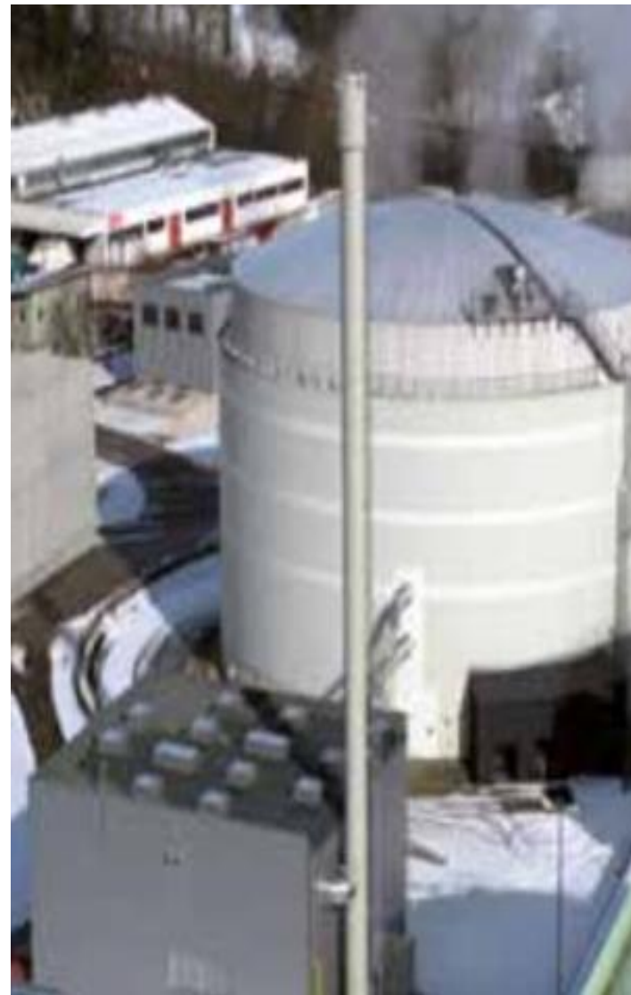
Timelkam: 20.000 m 3 , pressureless tank storage (Bildquelle: Energie AG)
